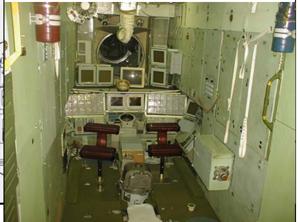
Рис.2 Вид на центральный пост управления ББ
